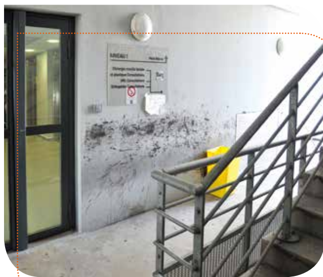
Les mégots sont éteints à même le mur.
